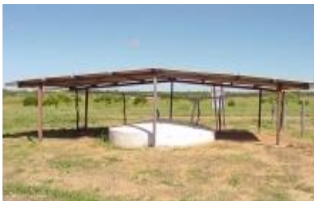
Figura 9. Cisterna rural de placas pré-moldadas.
