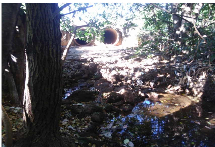
Figura 8. Tubulação do sistema de drenagem de águas pluviais que deságua no Córrego Sussuapara – Palmas – TO.
